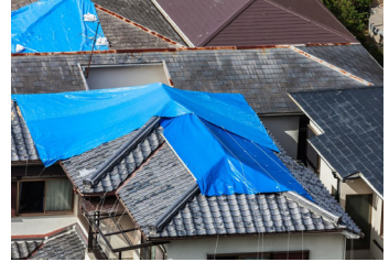
災害後のブルーシート
