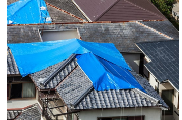
災害後のブルーシート
