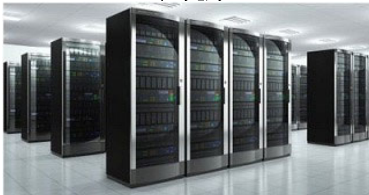
データセンター
