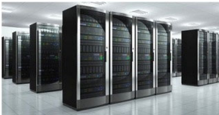
データセンター
