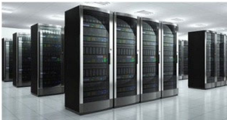
データセンター
