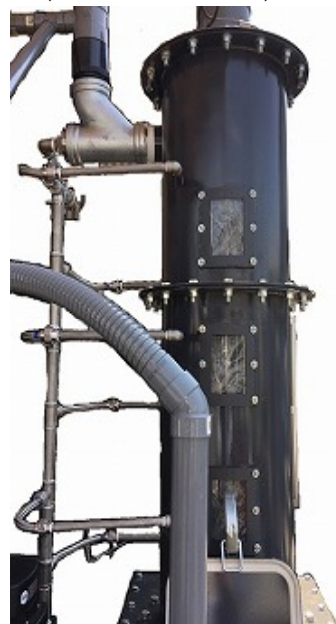
スクラバー (排ガス洗浄処理装置)
